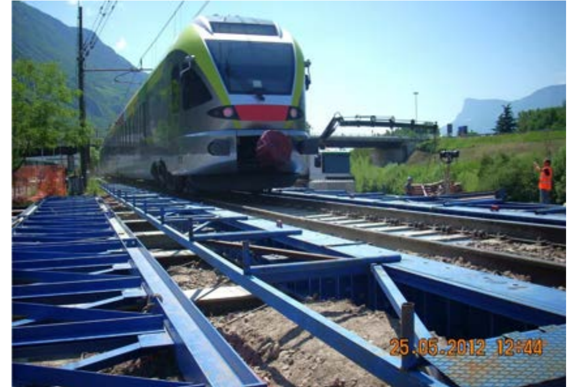
Imagen 5 - Sistema Verona instalado y tráfico de trenes activo
