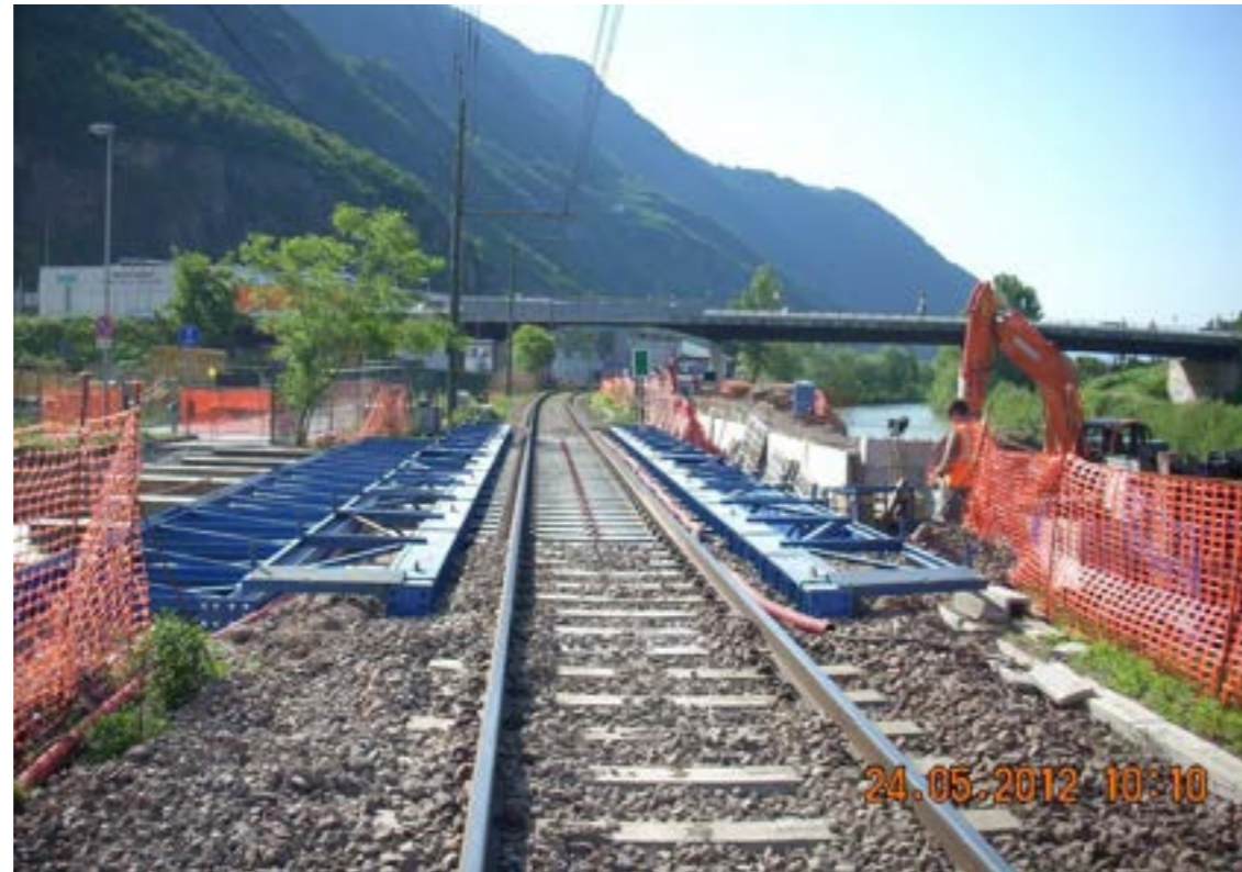
Imagen 2 - Sistema Verona instalado en las vías
