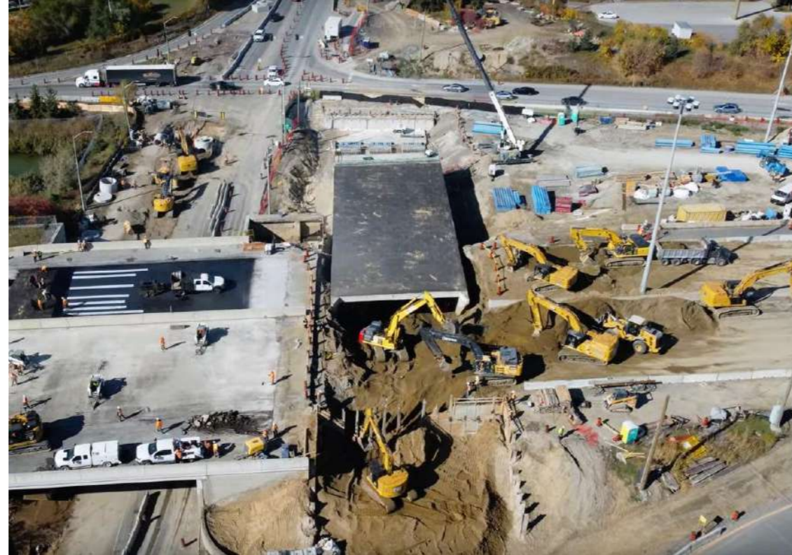
Imagen 5 – Hincada de paso inferior a cielo abierto y cierre temporal de carreteras
